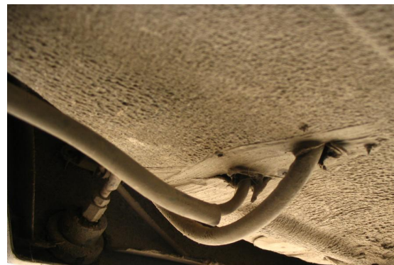
Slika 3 - Nema ventilacije multiventila
