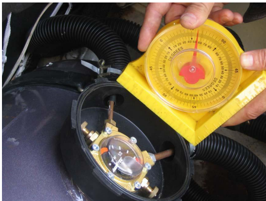
Slika 1 - Ugao ugradnje multiventila nije 30°
