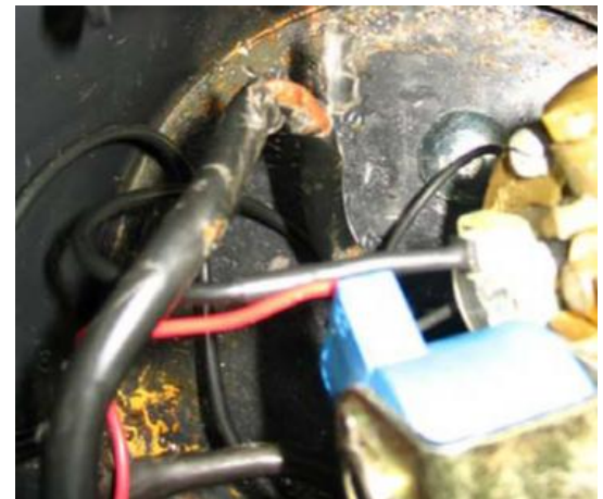
Slika 5 - Mehanički oštećena cev pri montaži
