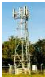
Slika 1 – Bazna stanica mobilne telefonije
